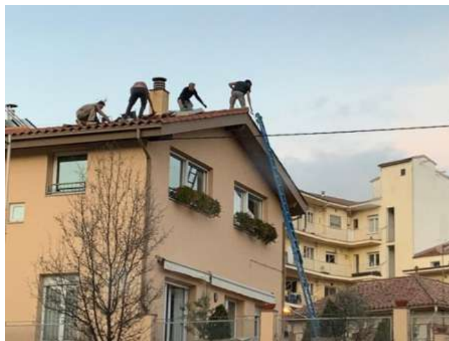
Fotografia d'obra d'instal·lació de plaques a coberta amb incompliment de la normativa de seguretat i salut, amb accés insegur amb escala de mà, manca de proteccions col·lectives i manca d'equips de protecció individual.
